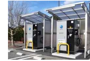
蓄電池・充電施設
