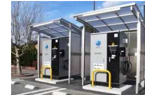
蓄電池・充電施設
