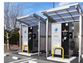
EVバスの 充電施設
