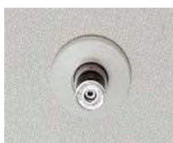
スプリンクラー設備
