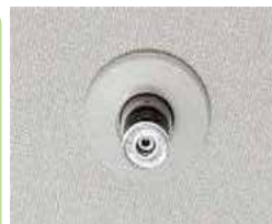
スプリンクラー設備
