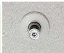
スプリンクラー設備
