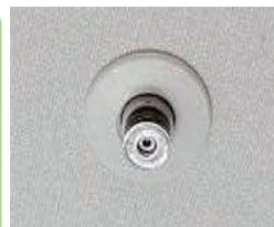
スプリンクラー設備
