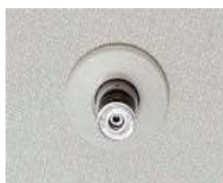
スプリンクラー設備
